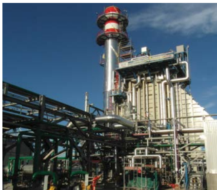
L'impianto di cogenerazione della raffineria di Augusta
