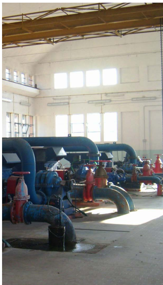
Interno sito di sollevamento
